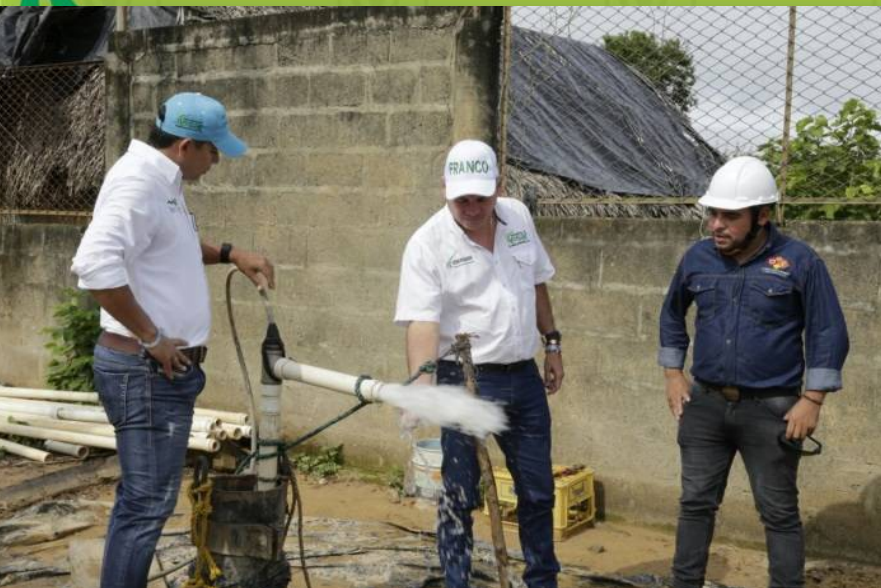
Pozo profundo: Barrio 19 de Mayo – La Paz
