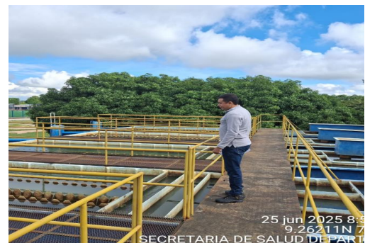
4. IVC SISTEMAS DE TRATAMIENTO DE AGUA
